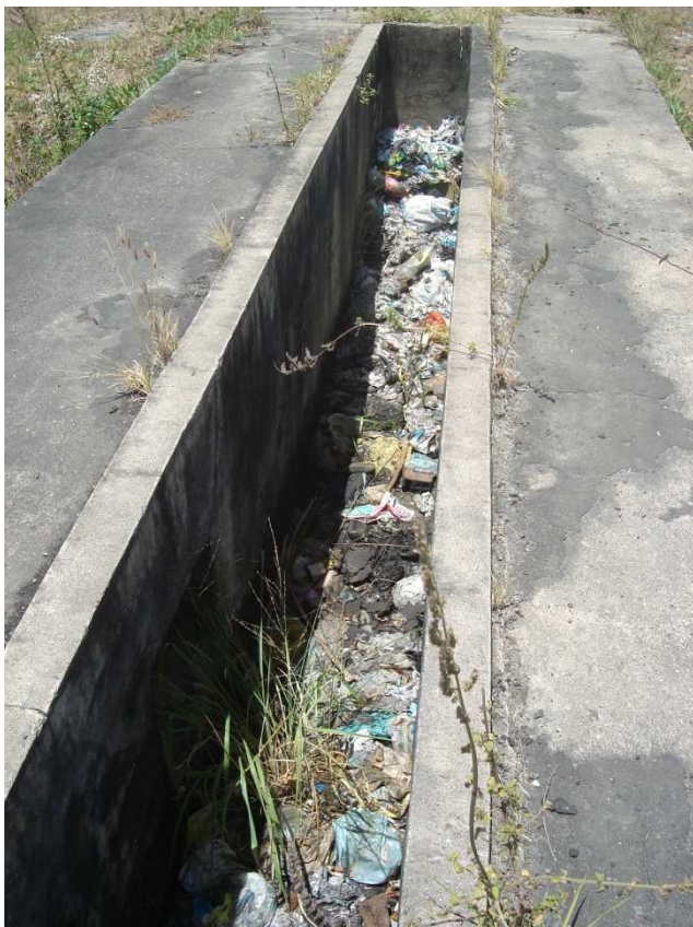
Figura 8. Acúmulo de lixo
